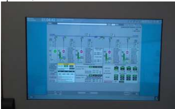
Рисунок 4 – современная панель управления судовой электростанции
